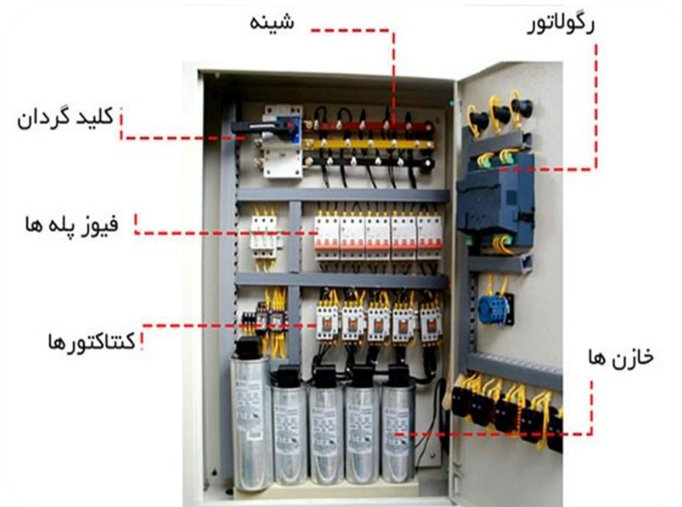
شکل ۶-۲ تابلو بانک خازن
